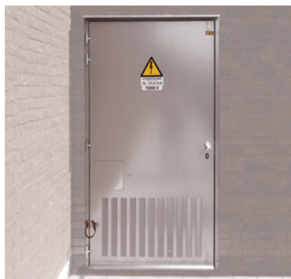
Cabine électrique / Synergrid
